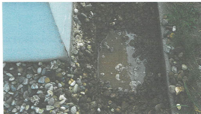
Abb. 6: Im Kiesstreifen staut sich Niederschlagswasser, das die (fehlerhaft ausgeführte) Sockelabdichtung und Bauwerksabdichtung überbeanspruchte
