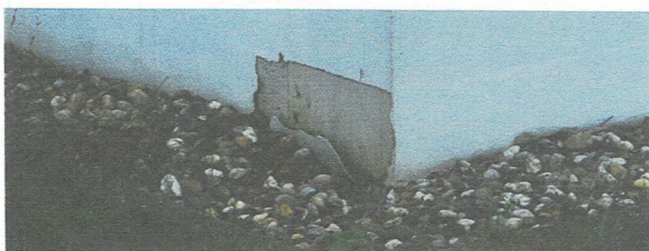
Abb. 4: Am Sockel des in Abb. 3 gezeigten Gebäudes sind am Kiesstreifen Schäden entstanden, ...
