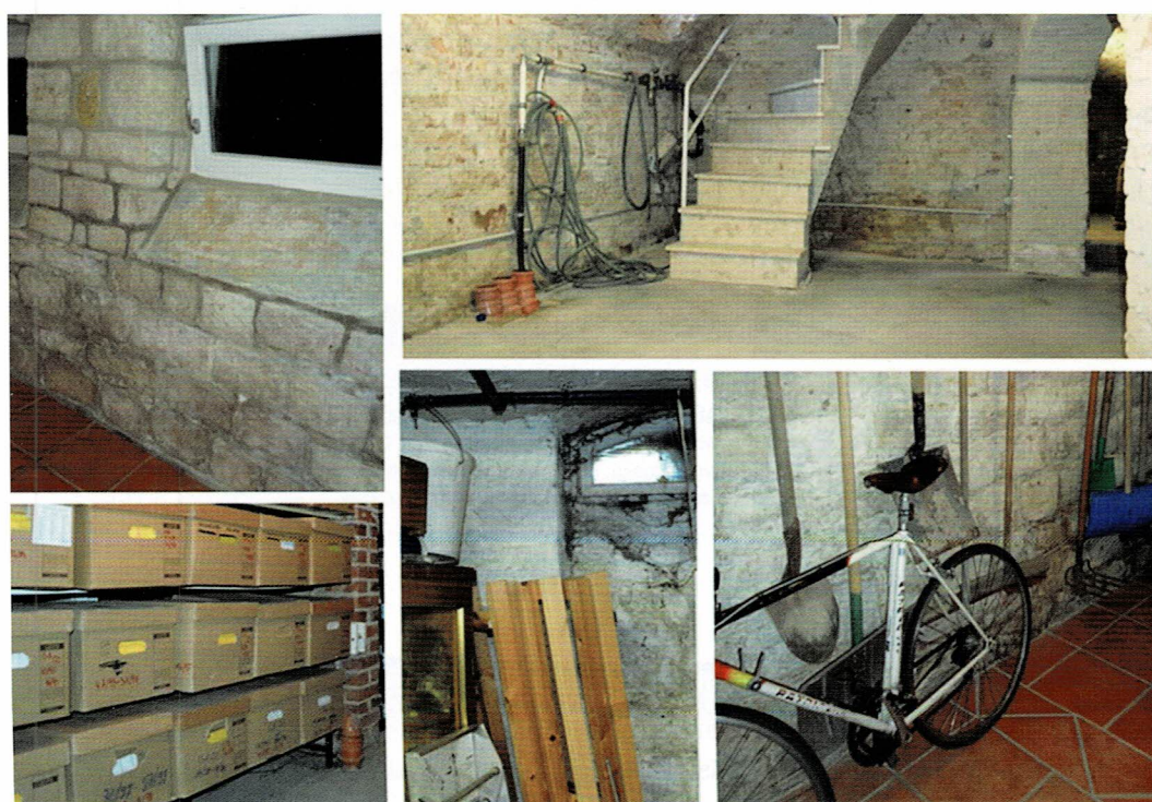
Abb. 2: Typische Situationen in Altbaukellern ohne Abdichtungen und ohne Dränungen bei Arbeitsraumverfüllungen mit in der Regel geringdurchlässigem, bindigem Bodenmaterial
